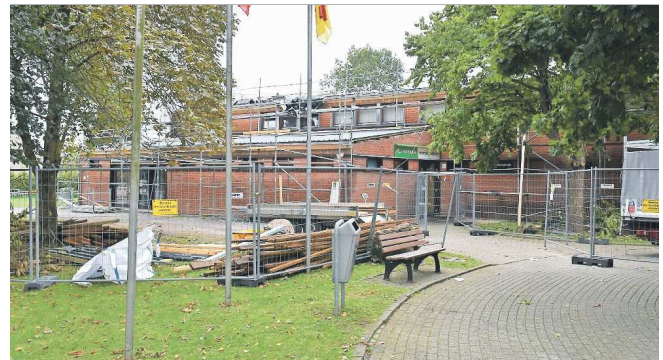
Auch die Absicherung der Baustelle ließ - und lässt teilweise immer noch - zu wünschen übrig.
